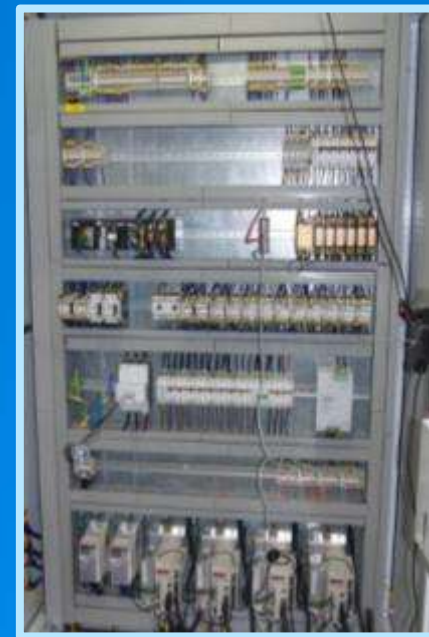
Rozvaděč výrobní linky Pohled na vnitřek rozvaděče
